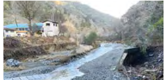
不土野小下堆積土砂の状況
