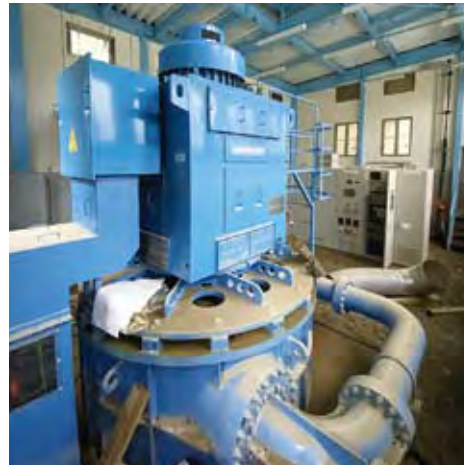
浸水被害を受けた発電所内部
