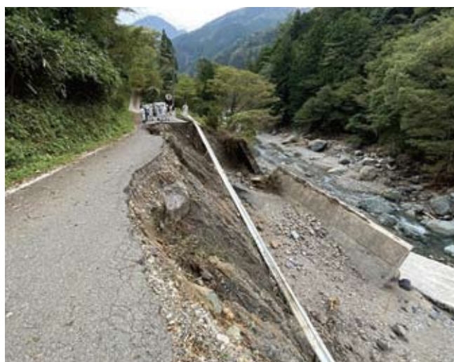
河川氾濫による国道388号の大規模道路災害 (大河内・本郷地区)
