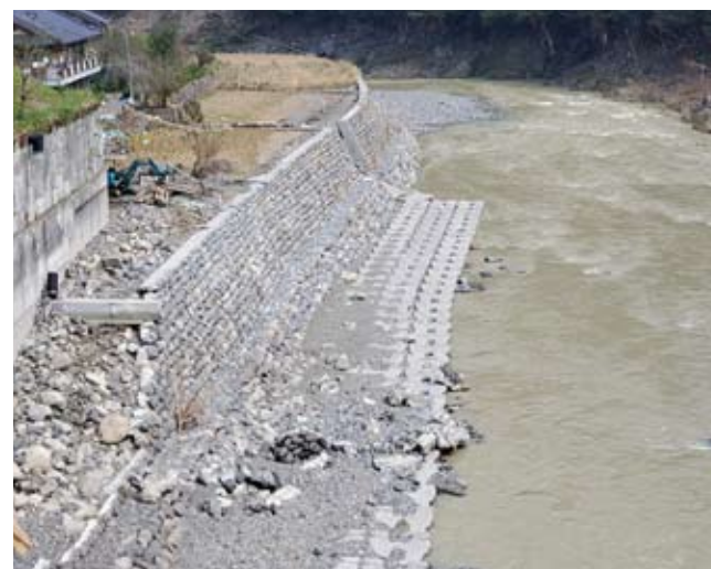
耳川の増水による護岸破壊と農地への土石 流入浸水災害(松尾・春地区)
