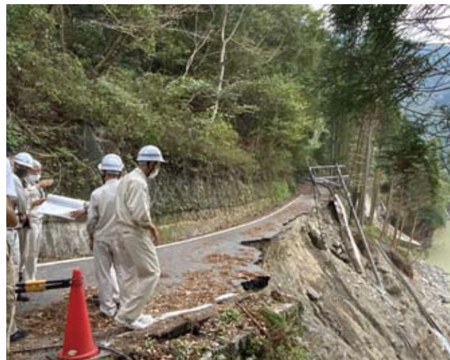
国道327号路肩決壊 県土整備部長が現地調査 (松尾・竹の八重地区)
