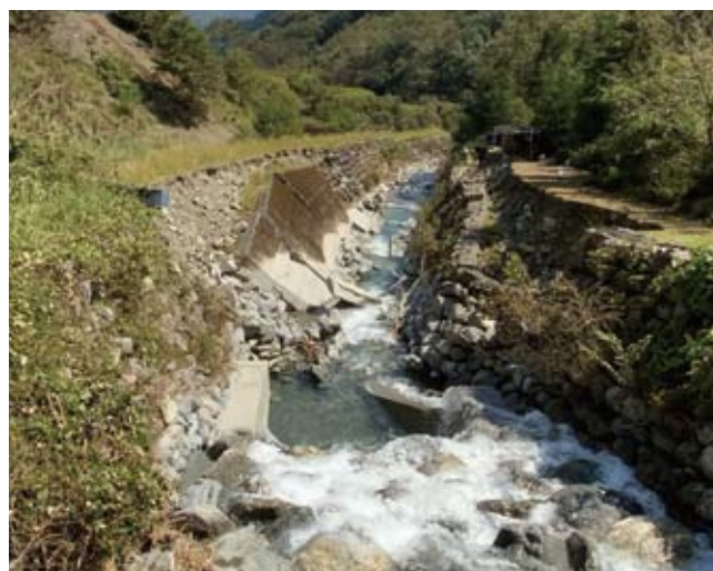
河川の氾濫による護岸災害(鹿野遊・内の八重地区)
