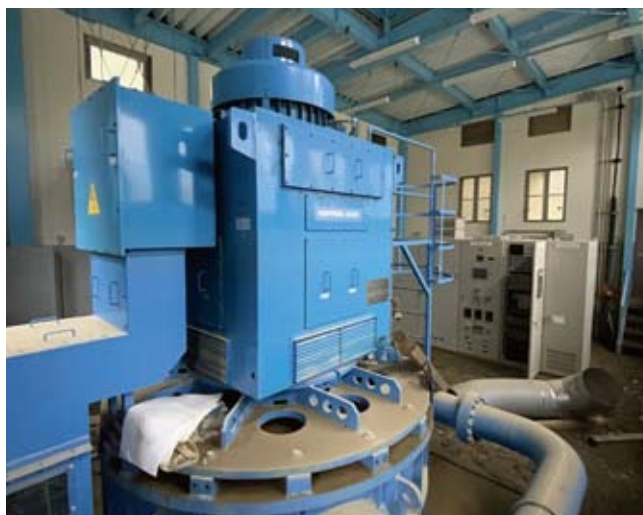
増水による発電機の浸水被害 (上椎葉・間柏原地区)
