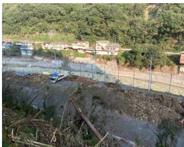
耳川の増水による河川護岸の災害 (松尾・岩屋戸地区)
