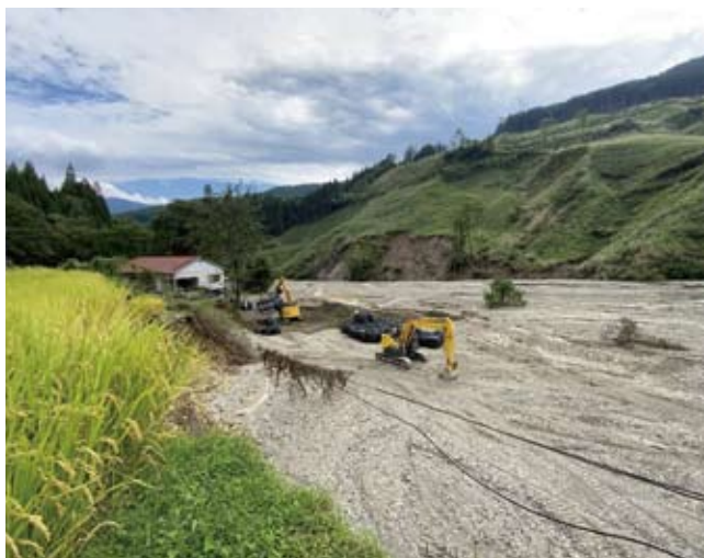
山腹崩壊による広大な土石が堆積、住宅保護の土嚢積み(不土野・不土野上地区)
