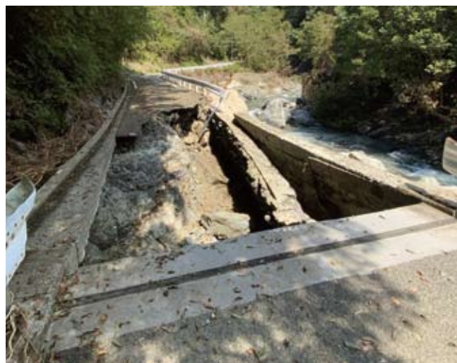
土石流による橋台部の災害(仲塔・奥村地区入口)
