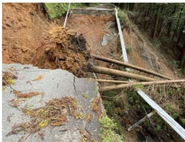
県道上椎葉湯の前線の道路決壊(不土野・不土野上地区)
