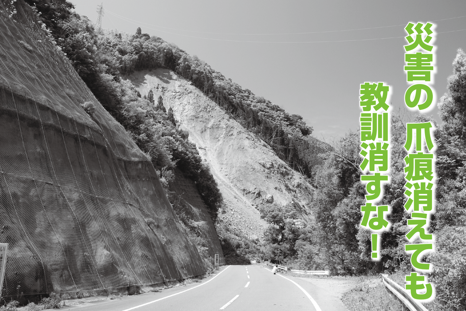
▲ 4月15日に発生した山腹崩壊で全面通行止めとなった国道327号（松尾 竹の八重地区）
