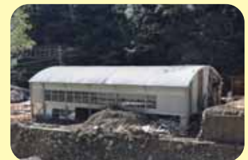
被災した鹿野遊地区体育館
