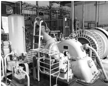
▲発電所の心臓部、発電機が設置され た機械室
